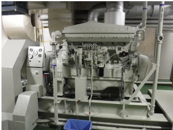
非常用発電機
