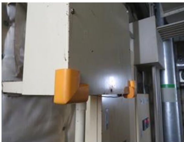
ウレタンクッション取付後のプルボックス
