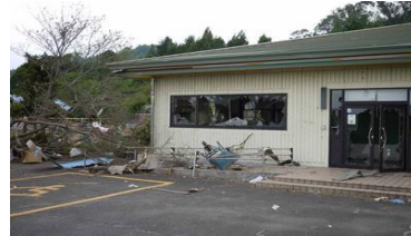
突風で被災した地区センター
