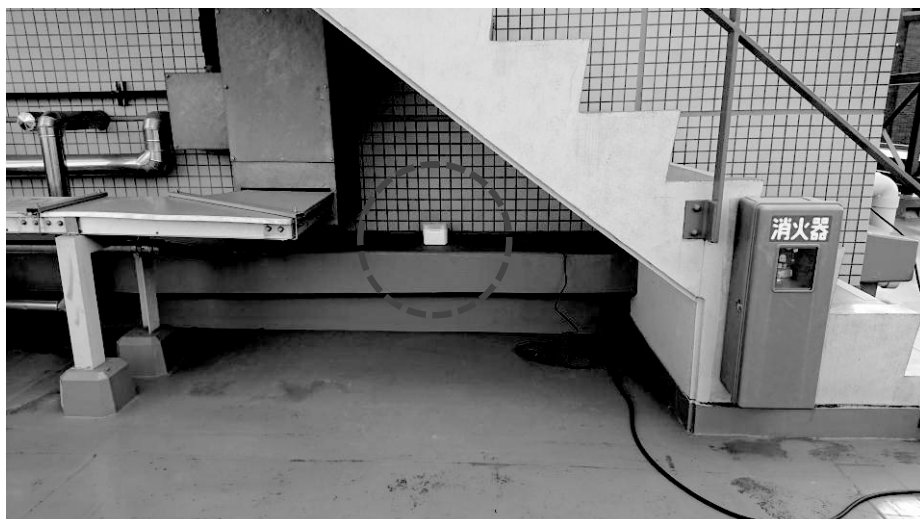
図3-2-3 測定機器設置状況・屋上 ※風雨と直射日光の影響を避けるために、階段下に設置しています。
