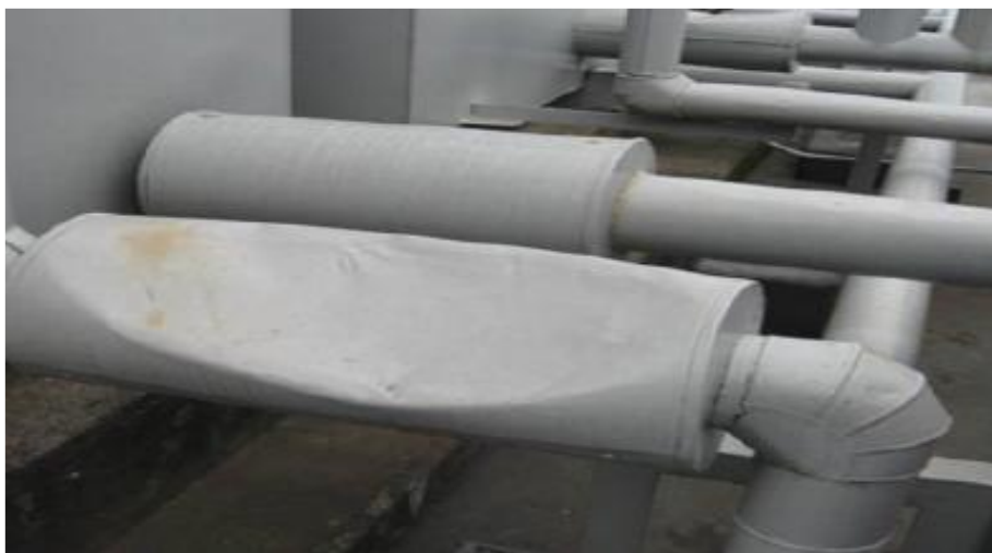
状況 10 : 冷媒配管のラッキングの破損と錆
