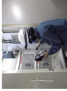
簡易部分放電測定
