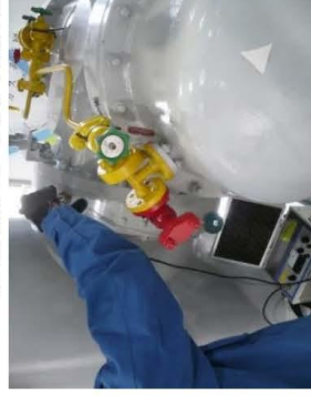
【絶縁スペーサーによる部分放電パルス検出】
