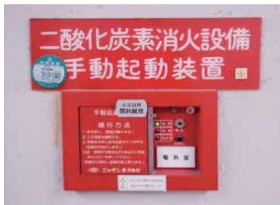
操作箱（手動起動装置）
