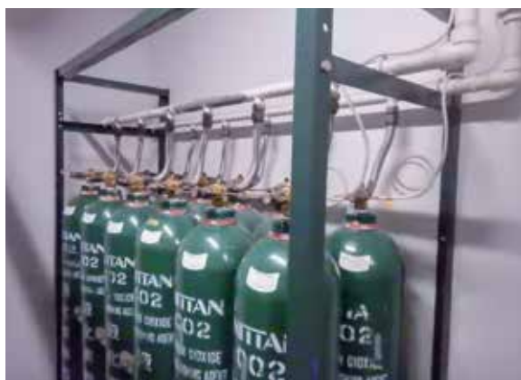
消火剤貯蔵容器
