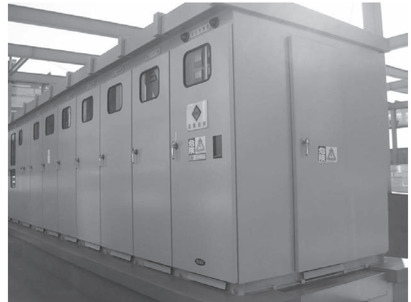
屋外キュービクル式受変電設備
