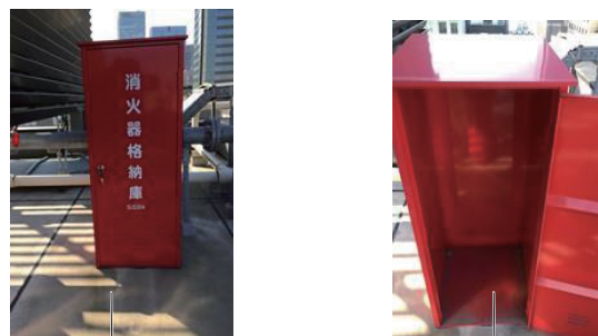
写真 4.3 消火器格納箱
