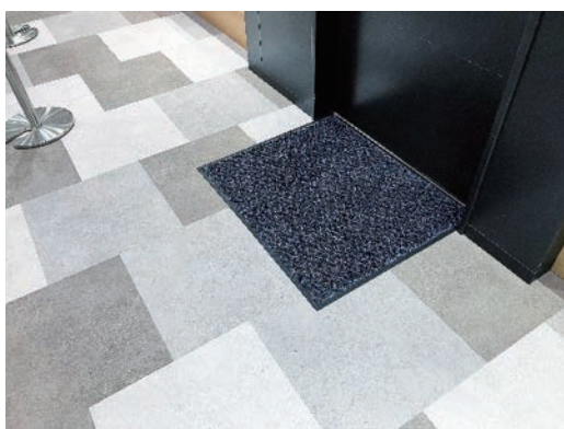
写真10 厨房出入口マット
