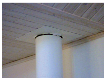
写真 2-9 配管貫通部 出典：(株)チノー
